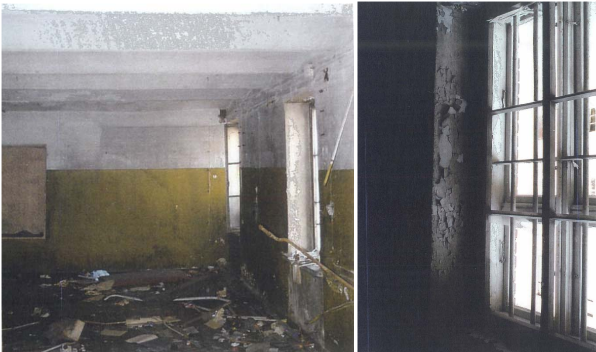
Foto 11. Tänaväärse hoone I korruse võlvistik ruumis 21 (pahemal) ja tänaväärse hoone I korruse aken enne sulgemist.
