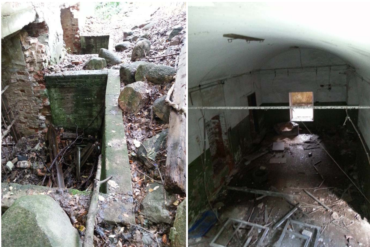
Foto 5. Pinnase liikumisest tekkinud kahjustused hoone Toome poolses küljes (pahemal) ja sissevaade keldrisse Toome poolsest küljelt.
